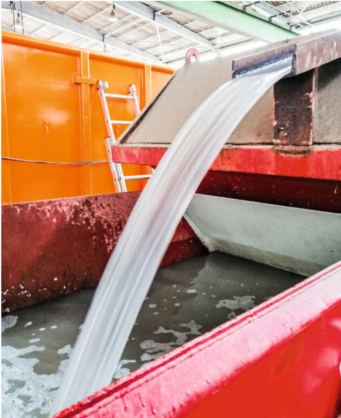
Das nahezu klare Wasser wird als Prozesswasser weiter genutzt, überschüssige Mengen fließen über das öffentliche Kanalnetz zur Kläranlage. | Foto: Kahnenbley
