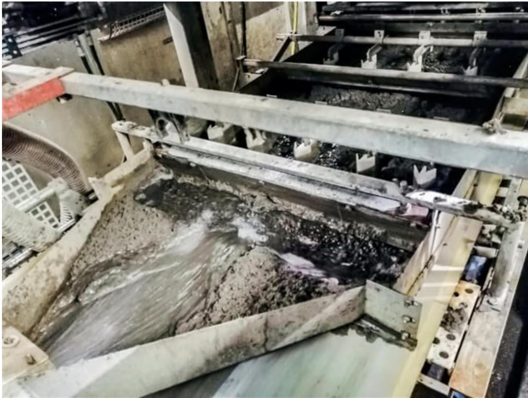
Die Spülung mit den Feianteilen läuft in die Siebbandpresse. | Foto: Kahnenbley
